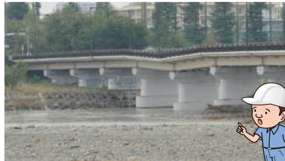
日野橋陥没の様子(10月18日撮影)
