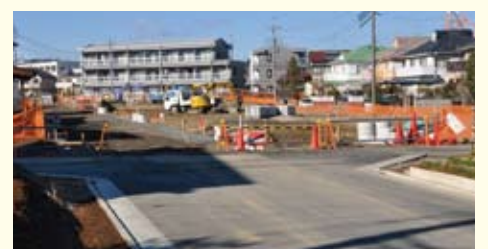
日野市では、西平山・豊田南・万願寺第二・東町地区にて、組合施行の川辺堀之内地区を入れると合計 5 地区で区画整理が進行中
